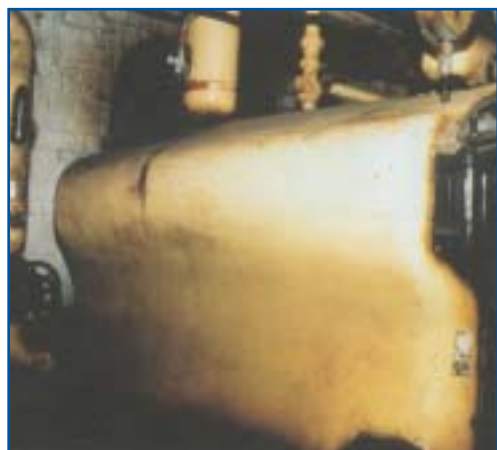
Λέβητας που φέρει μόνωση από αμύαντο καλυμμένος με ένα σκληρό επίχρισμα
