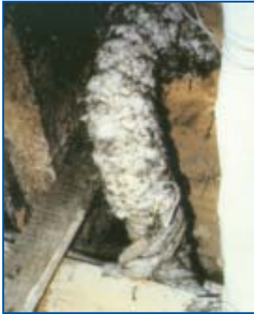
Σωλήνας με μόνωση από αμιαντόσχοινο
