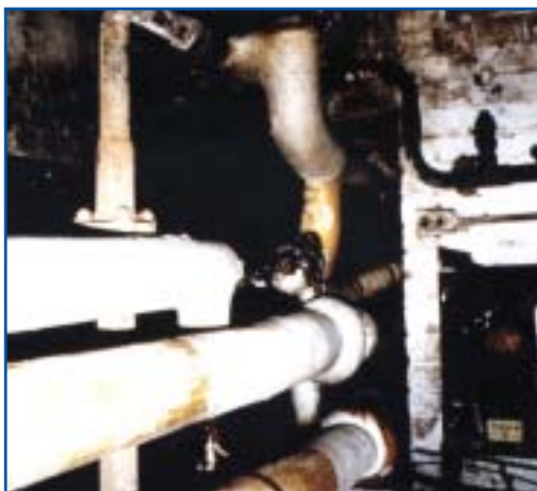
Σωληνώσεις κεντρικής θέρμανσης με μόνωση από αμύαντο
