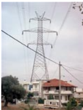
Γραμμές υπερυψηλής τάσης 400kV
