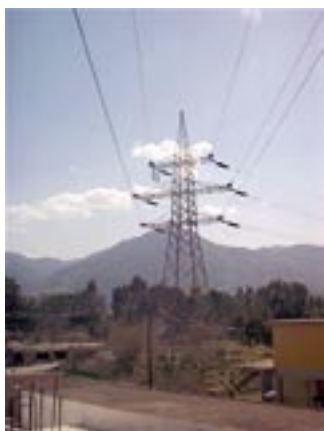
Γραμμές υψηλής τάσης 150kV
